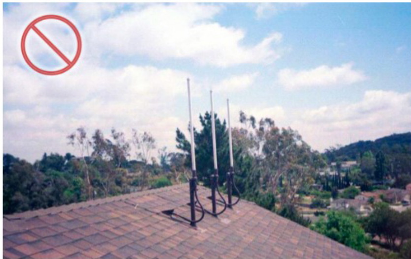
Ошибка! Верхняя кромка кровли крыши срезает диаграмму антенны.
